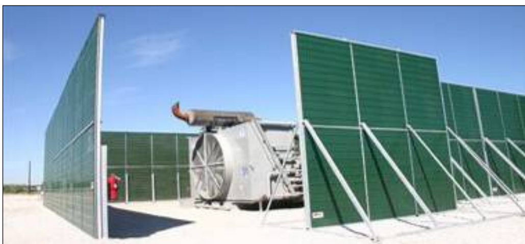
Εικόνα 9-1: Χρήση ηχοπετασμάτων σε σταθερές πηγές θορύβου
